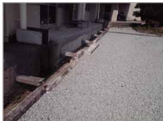
7/14・7/15活動 ・川内村体育館 周辺破損状況
